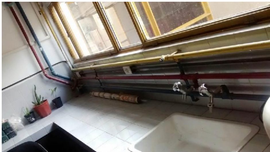
Figura N°10: Vista parcial instalación agua caliente.
