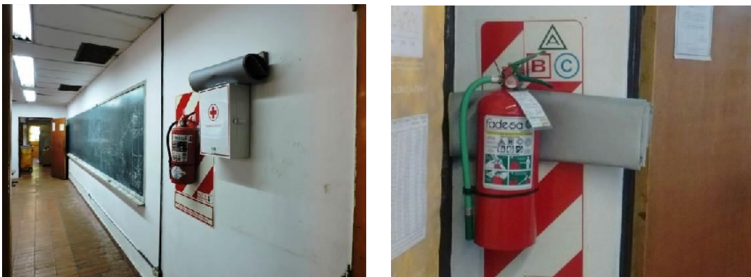
Figura N° 30 – Figura N° 31: Vista de Algunos de los extintores reemplazados y mantas ignífugas
