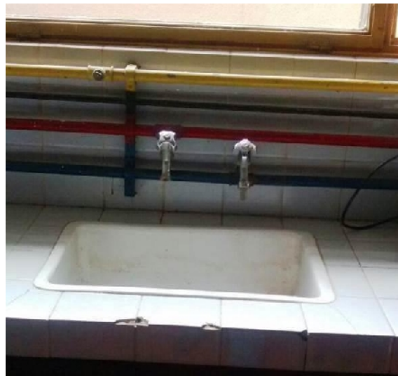
Figura N°9: Provisión agua caliente.
