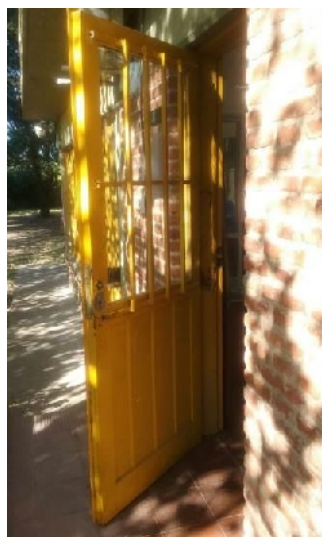
Figura N°4: Cambio de sentido de apertura puerta exterior.
